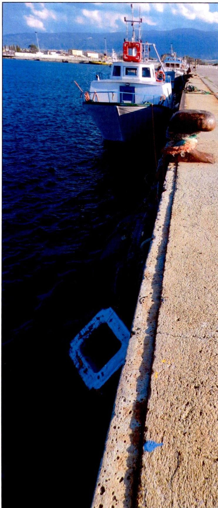
Servizio Fotografico Patologie banchina n°3
