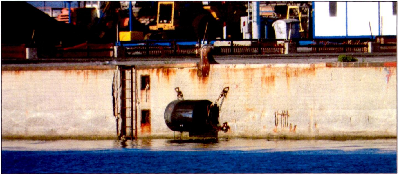
Servizio Fotografico Patologie banchina n°1 alla data del 19/09/2012
